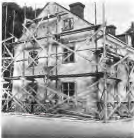
Bild 15. Gaveln mot Svartbäcksgatan; under övervåningens fönster synas igensättningar efter Rudbeckshusets lägre placerade fönster. Å hitre hörnpilastern står efter de avbilade listprofilerna.
