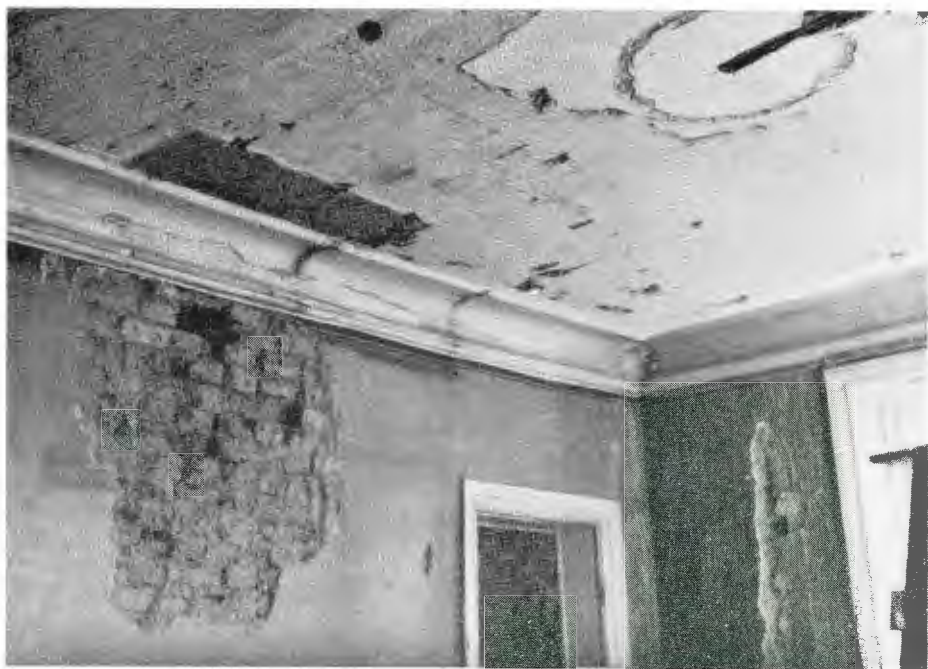
Fig. 9. Rummet till vänster om nedre stora salen (nuv. »Klädkammaren») under restaureringen; t. v. sår i takputsen efter det gamla kakelugnsprånget; mitt i taket sår efter krans till takkrona.
